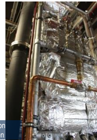
Anlage zur Untersuchung von Thermoblech-Kondensatoren
